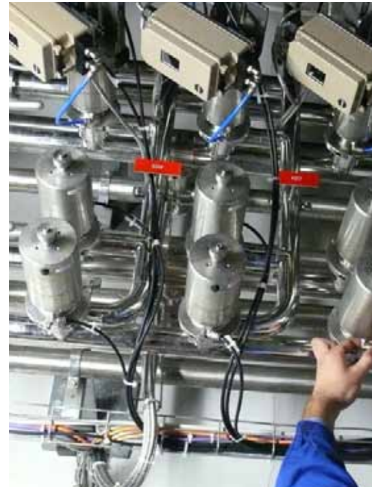
Funktionsprüfung eines Steuerventils
