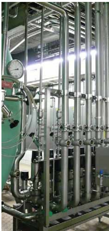
Ventilknoten eines Rohrleitungssystems
