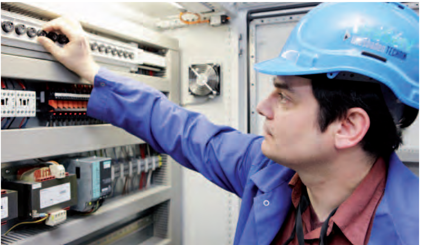
Sicht- und Funktionsprüfung einer Steuerungstechnik
