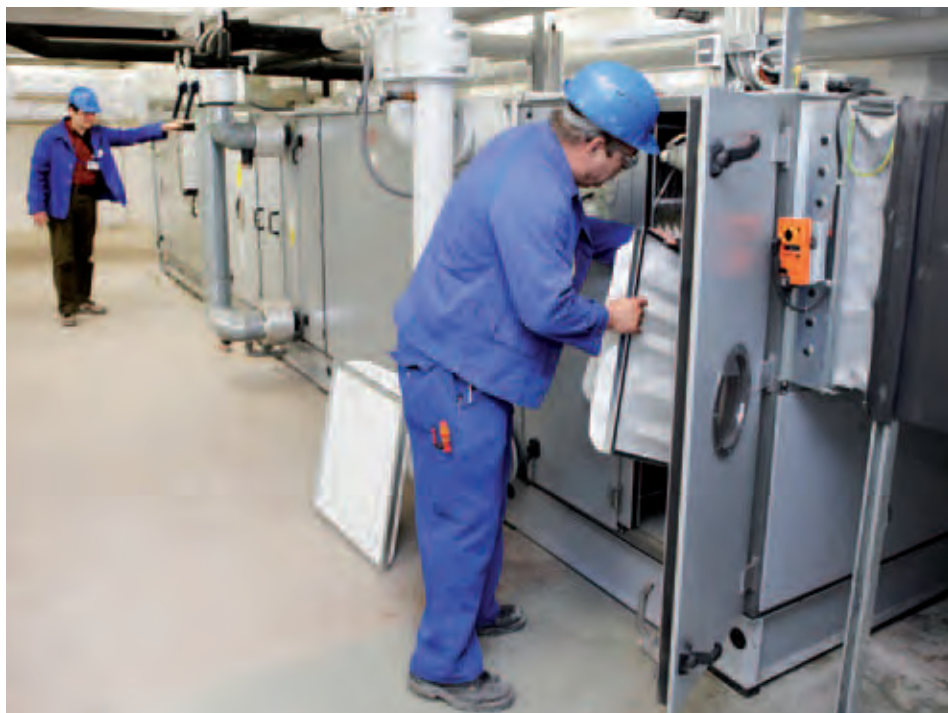
Inbetriebnahme einer Lüftungsanlage
