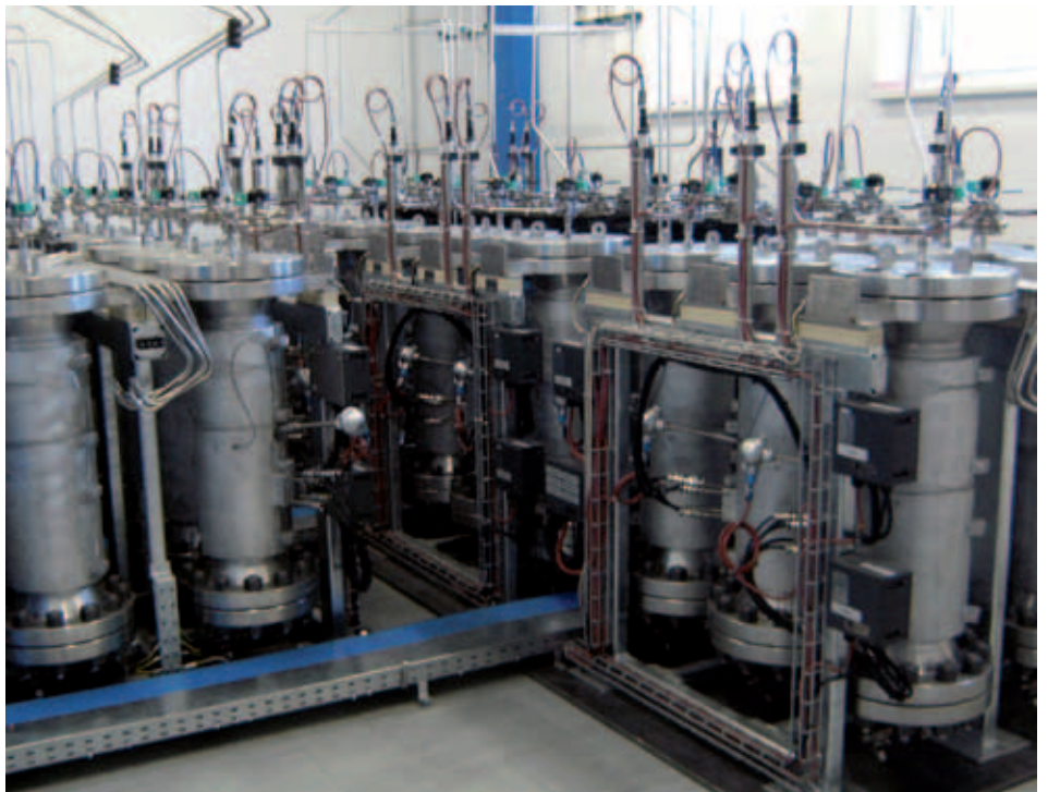
Gasreinigungsanlage für ein Polymertechnikum
